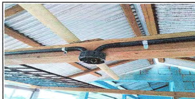
Foto 4: Evidencia las nuevas instalaciones eléctricas de la escuela Caserío Arenal II.
